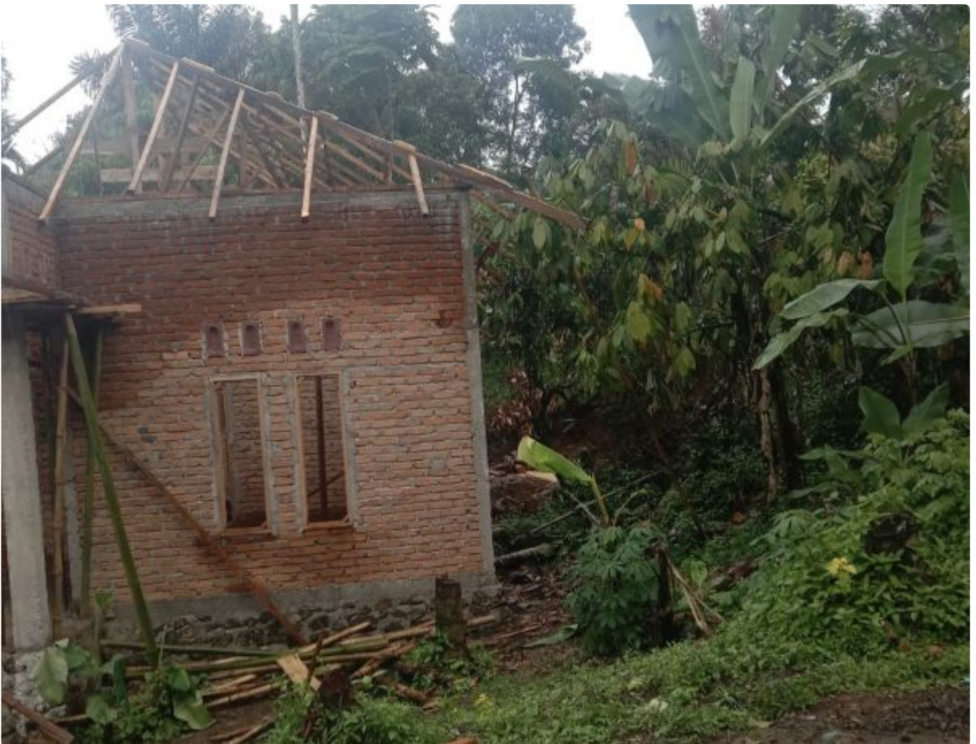
Rumah Dibangun Ilegal di Banca Laweh, Simpang, Bonjol
